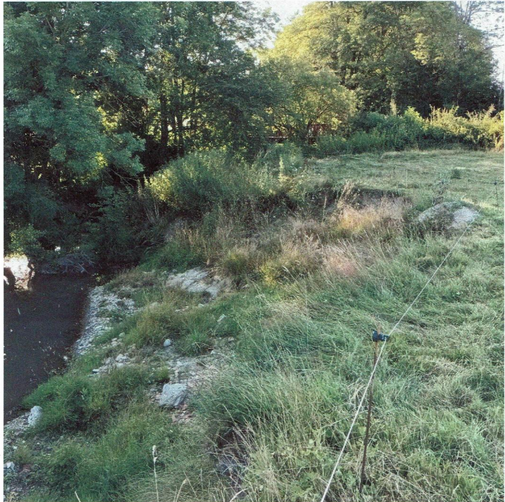
Berges érodées avec les hautes eaux de la Biesme (en amont du pont )
